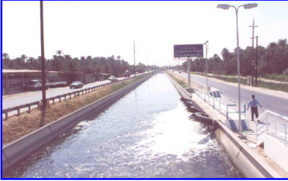
مشروع إعادة استخدام مياه الصرف الزراعي
